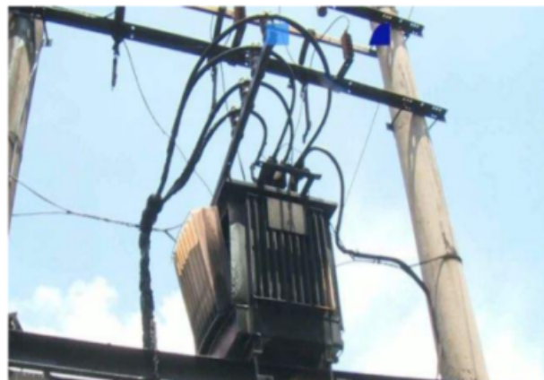
变压器因过载被烧毁
